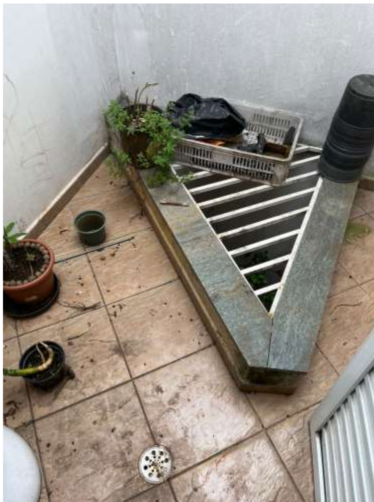
Foto nº. 24 – Vista da ventilação.
